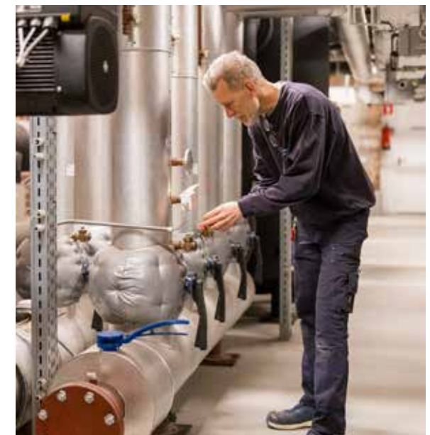
In de kelder staan enorme warmte-koude-installaties voor de duurzame klimaatbeheersing van het museum
