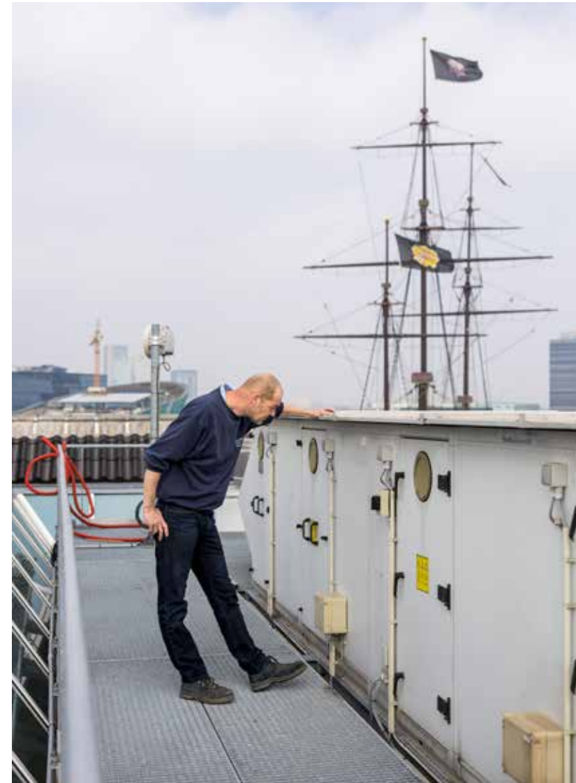
Erwin Stegenga inspecteert de luchtbehandelingskasten op het dak
